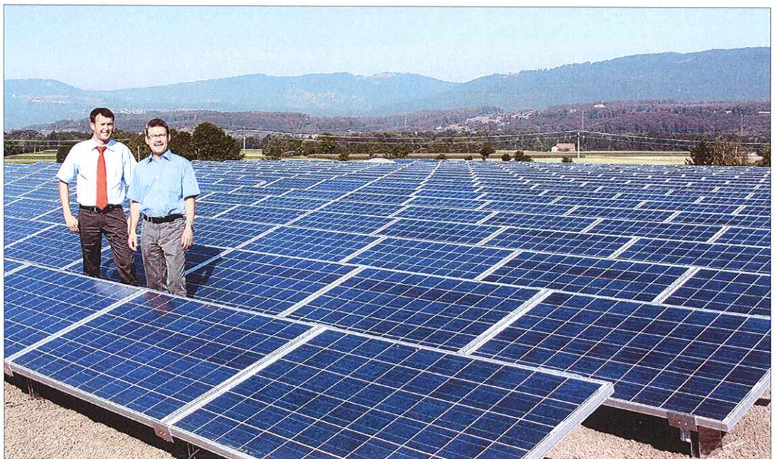
MIT WEITBLICK Thomas Peter (links) und Armin Zingg, die Initianten der Photovoltaikanlage auf dem Fabrikdach. osa
